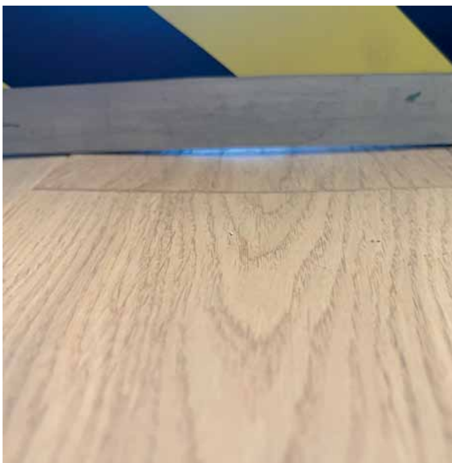
Slika 1: Najčešće greške koje se pojavljuju na drvenim podovima posle nekoliko meseci od postavljanja.
