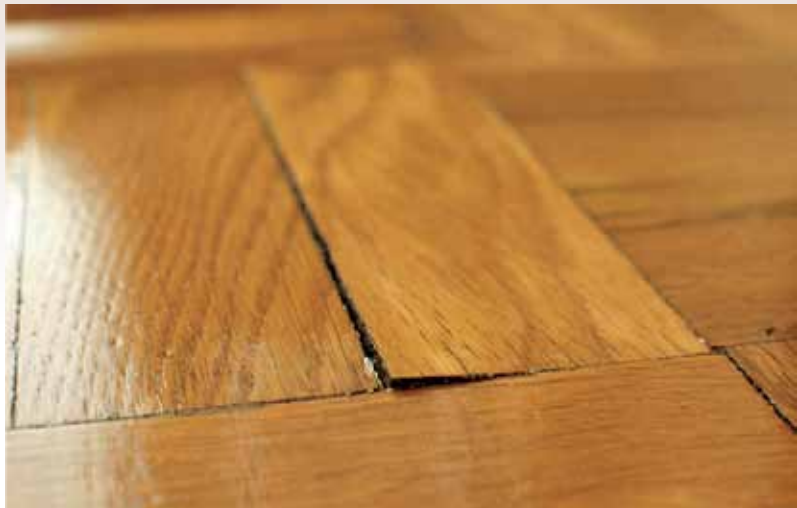
Slika 1: Deformacija na parketnom elementu kao posledica reakcije drveta i vlage
